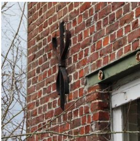
Figuur 26: Muuranker in oude woning
