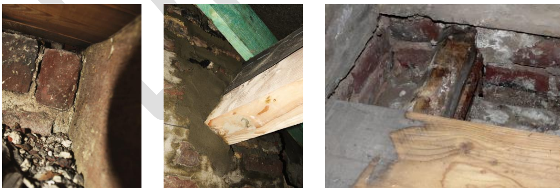
Figuur 14: Foto's uit bestaande woningen, waar de voeg tussen balk en metselwerk opgevuld is met mortel.
